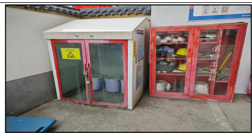
危废暂存库及消防设施
