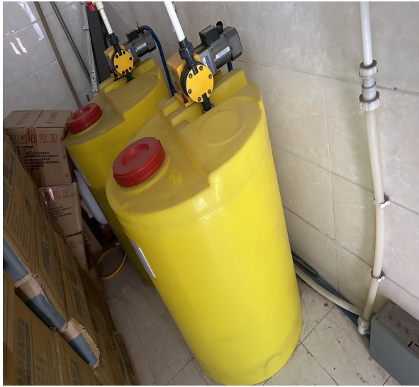
依托工程一污水处理设施的消毒装置
