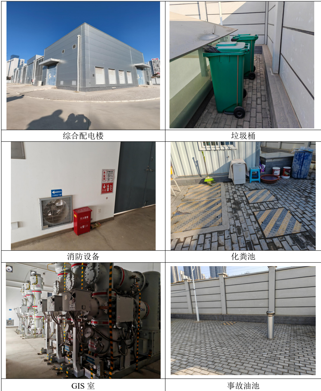
图 2-8 沈家桥 110kV 变电站内部分设施现状
