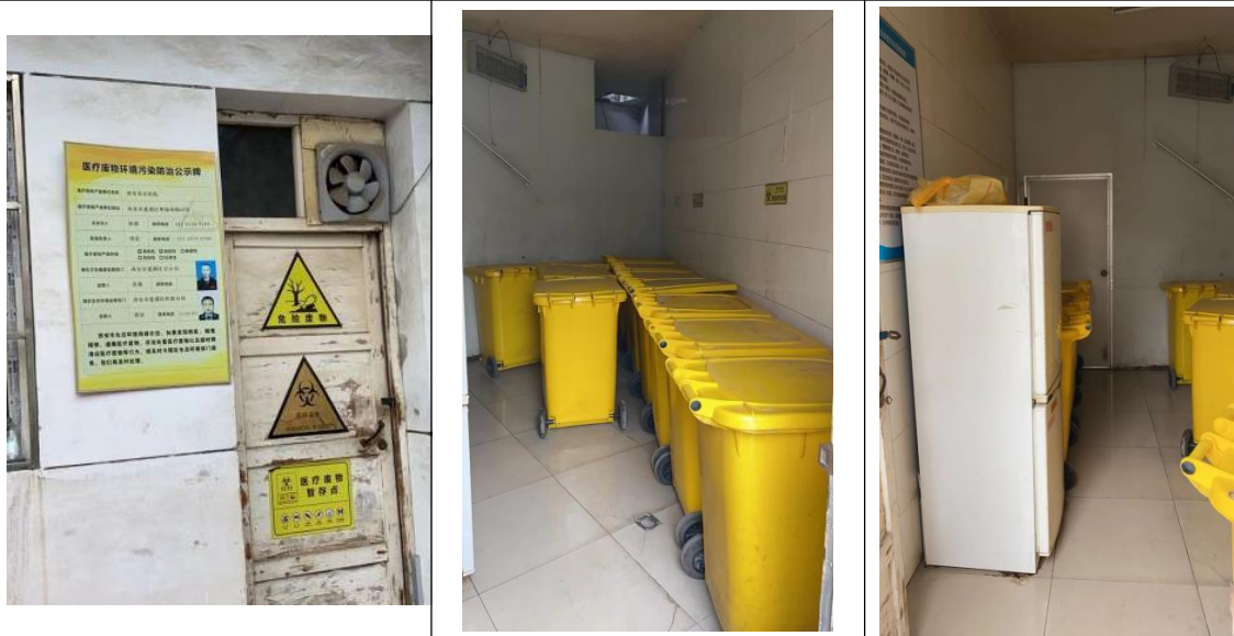
图 9-4 医疗废物暂存间
