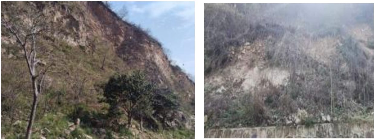
抱龙峪内水土流失治理点现状
