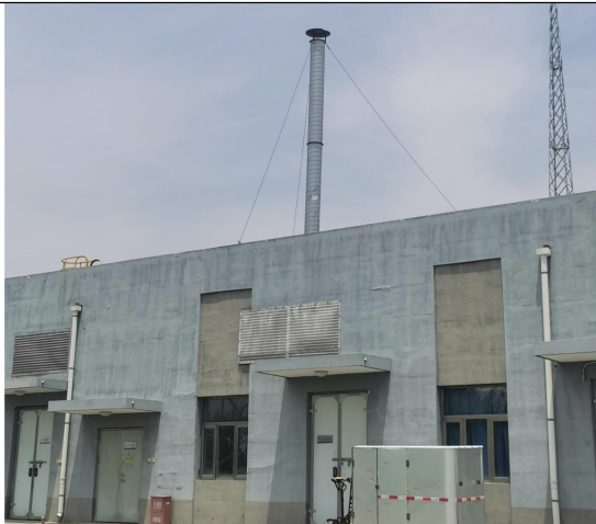
点火具车间现有排气筒 (DA001)
