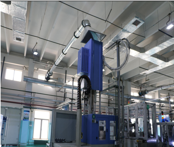
注塑废气收集设施
