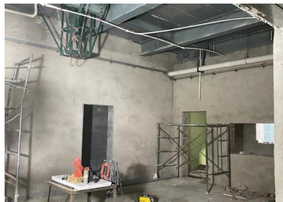
DSA 机房现状
