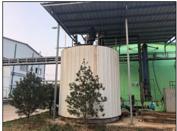
现有冷冻水储罐
