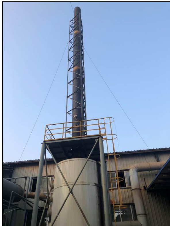
现有生产车间南侧三级吸收塔
