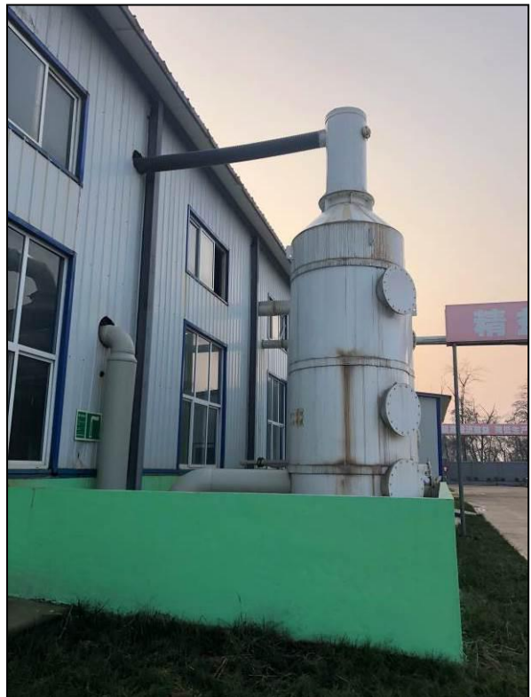
现有生产车间北侧氨水吸收塔
