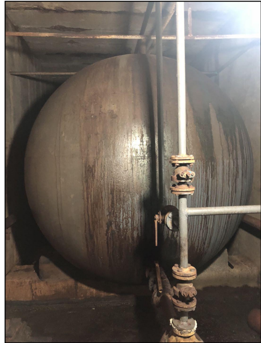
现有硫酸储罐
