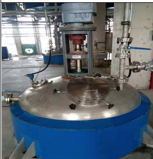
致孔剂搅拌罐
